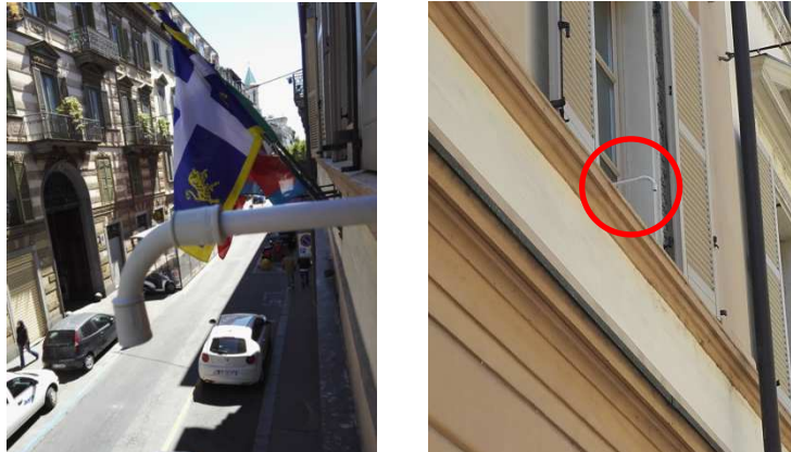
Figura 11 – Installazione postazione in edificio pubblico - Installation of the monitoring station in a public building.
